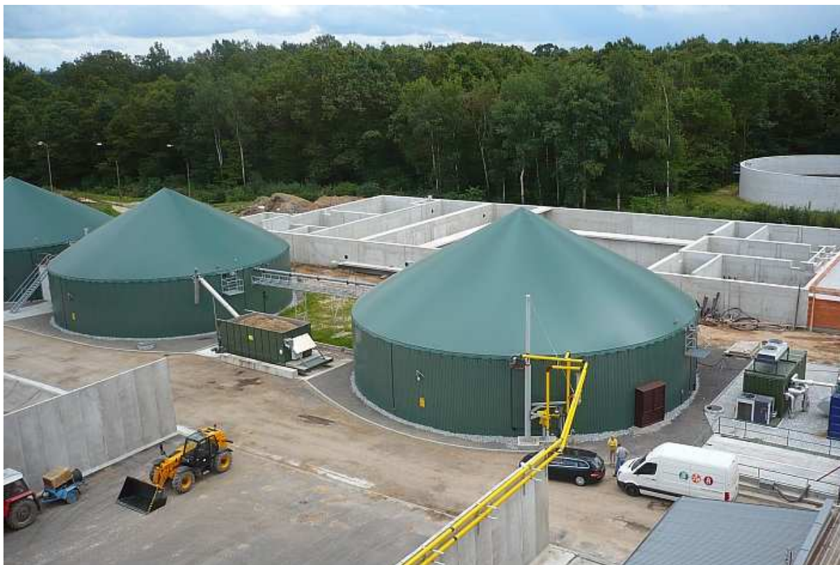
Bioplynová stanice Třeboň zásobující teplem místní lázně
