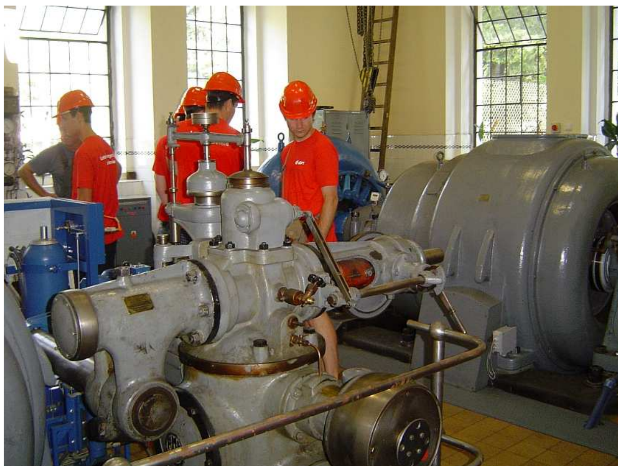
Prohlídka strojovny malé vodní elektrárny Soběnov
