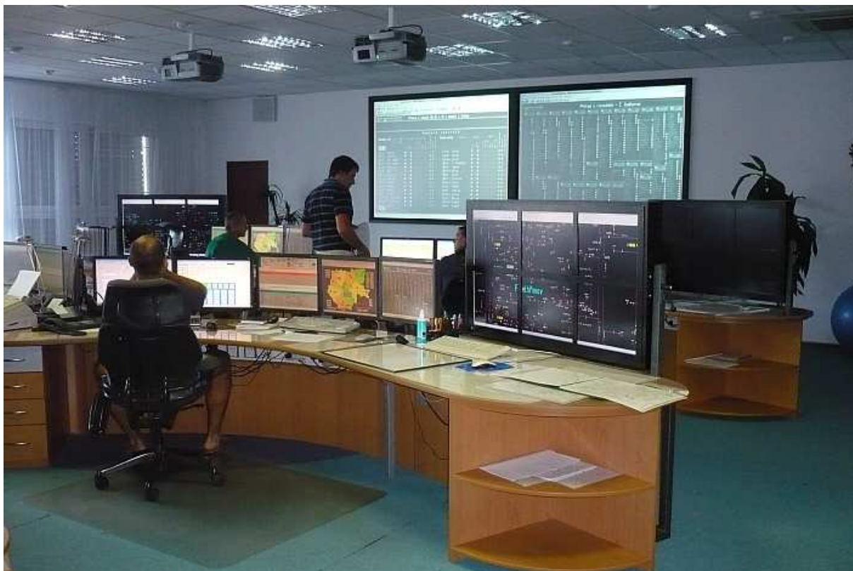
Pracoviště dispečinku v Českých Budějovicích, pracoviště dispečera sítě 22 kV
