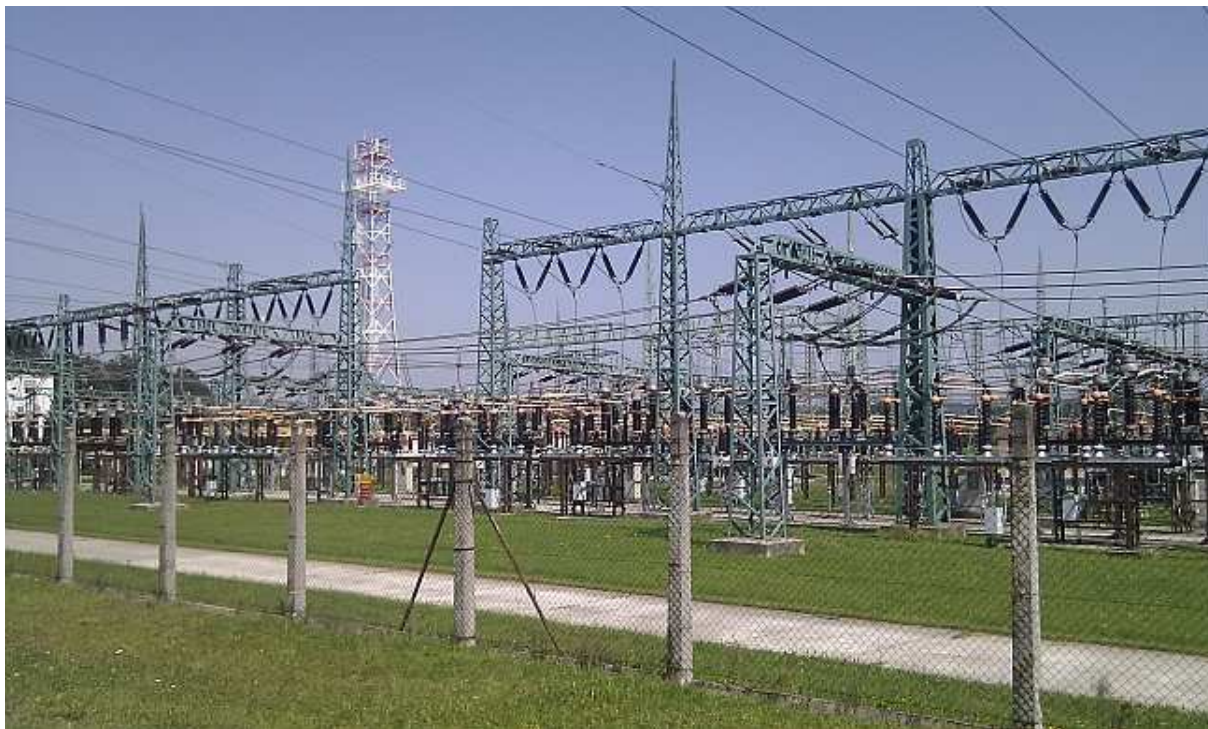
Rozvodna Dasný, důležitý uzel elektrizační soustavy
